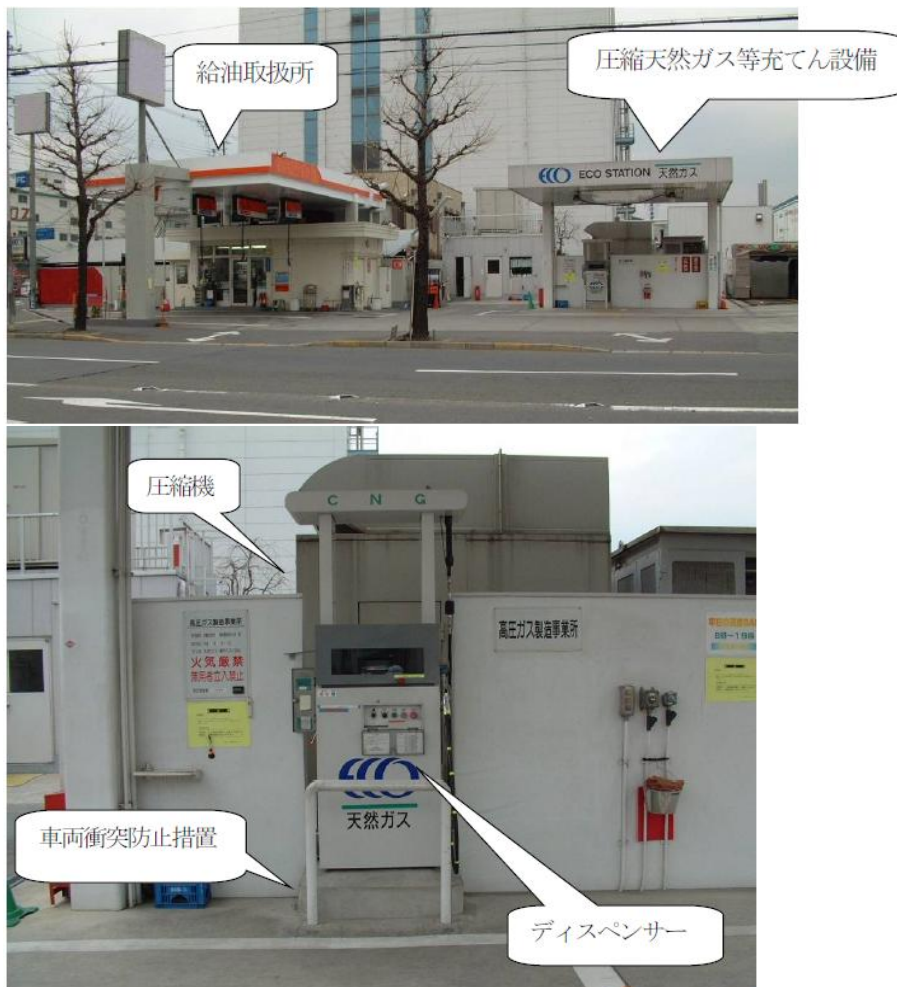
図 圧縮天然ガス等充てん設備設置給油取扱所の設置例
