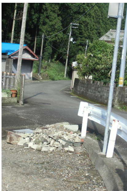
(県道下に2本目の排水路が望まれる)
