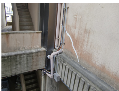
(ひび割れがある現庁舎)
