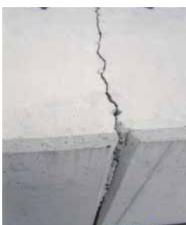
(亀裂のはいった堤防)
