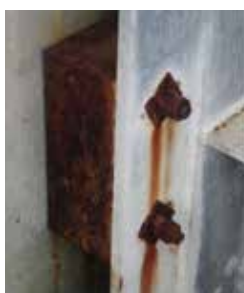
(浮棧橋を支える鉄柱の取付金物とナットのサビ)
