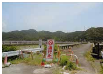
(現在通行止めとなっている旧日置大橋)
