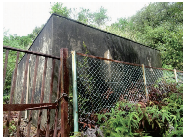
簡易水道施設
