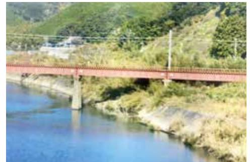
(護岸が一部欠損している日置川のＪＲ鉄橋橋脚付近)
