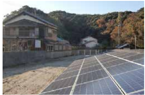
住宅街に設置された太陽光発電
