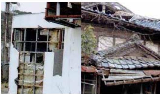
対応が求められる危険性の高い空き家
