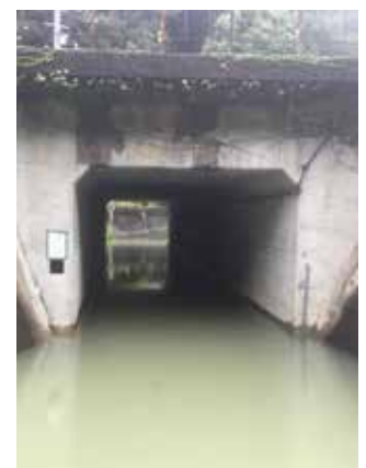
(冠水した町道朝来帰新田線)
