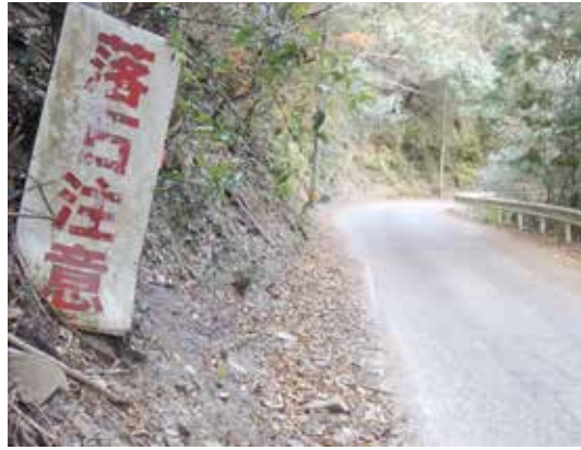
(落石の多い日置川大塔線)
