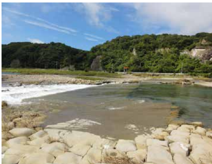
(台風20号で被害を受けた大井堰)
