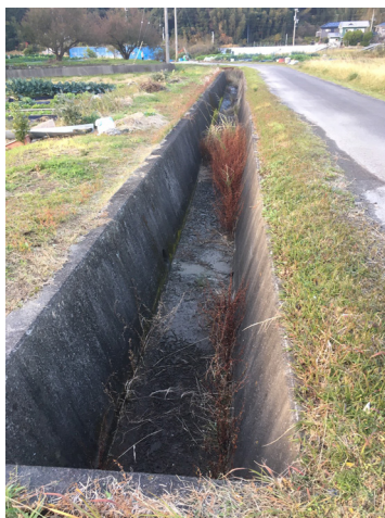
(安全柵が必要な町道脇 の深い側溝)
