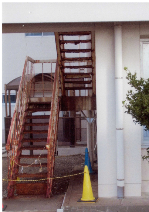
(非常時に使用できない非常階段)
