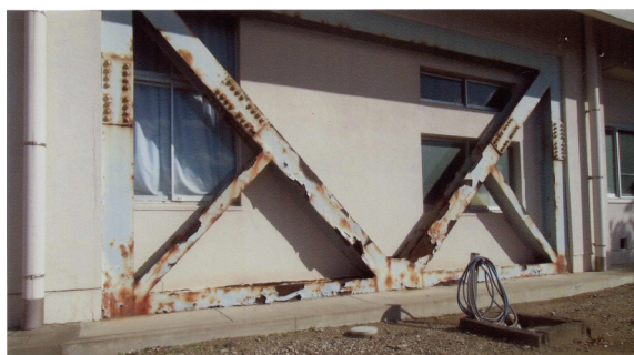
(腐食が進む日置中学校のブレース（筋交い）)
