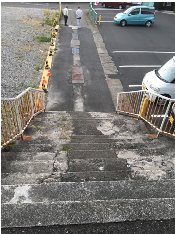
(転倒事故があった 老朽化した町道)
