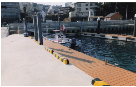
(欠陥工事が浮き彫りとなっている湯崎漁港浮桟橋)
