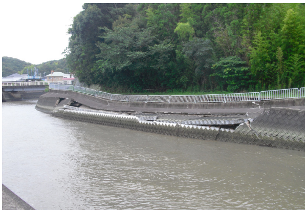
(昨年の台風で被災した町道開キ芦永線)
