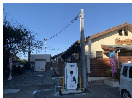
電気自動車用急速充電器
